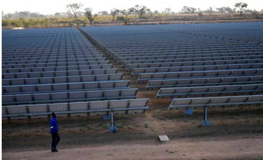
Klimafinanzierung kann die Kosten von Alternativen zu fossilen Energieträgern senken: Solarpark in Simbabwe.
