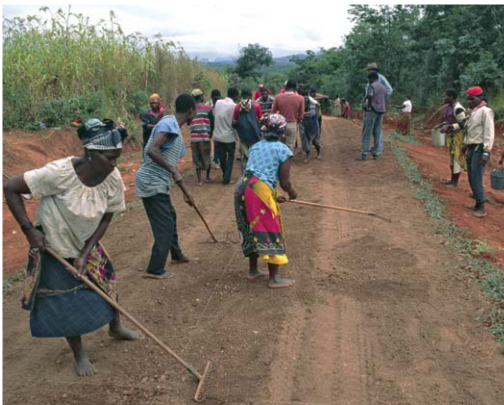
Seltene Einigkeit in Mosambik: Anhänger von Frelimo und Renamo arbeiten zusammen am Bau einer Straße.
