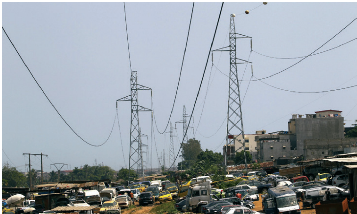
Regionale Gemeinschaften stellen ihre eigenen Handelsregeln auf, westafrikanische Länder handeln zum Beispiel zunehmend untereinander mit Strom: Übertragungsleitungen in Abidjan, Elfenbeinküste.
